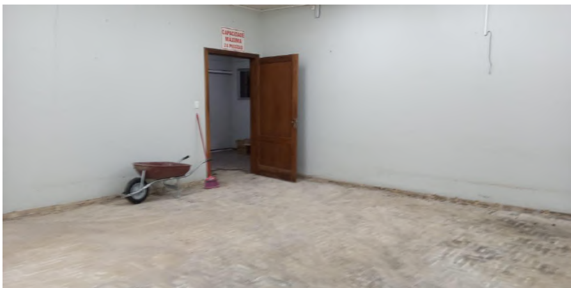
Foi retirado o piso de taco para o início da colocação do piso cerâmico
